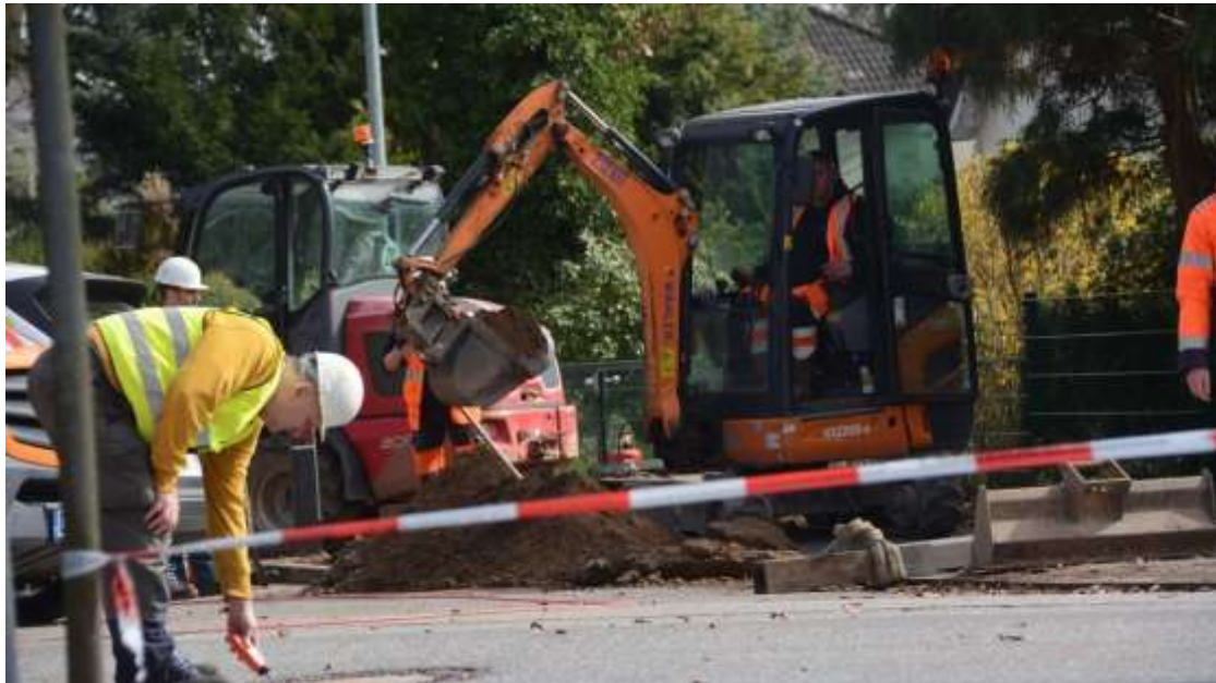
Der Bagger, der die Leitung getroffen hatte
